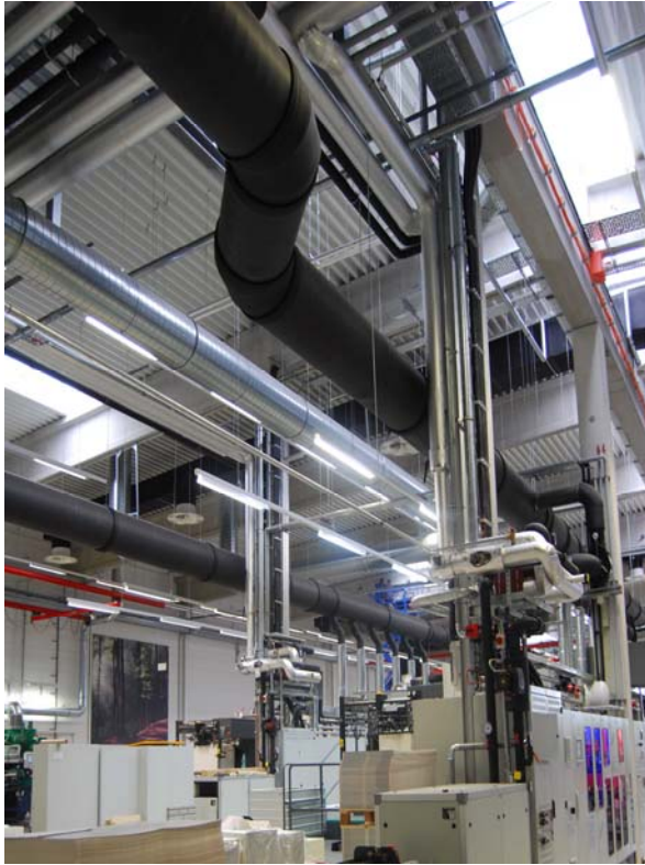
Bild 1: Das aufgeheizte Kühlwasser und die nutzbare Abluft werden an einem Wärmetauscher vorbei in einen zentralen Pufferspeicher geführt.
